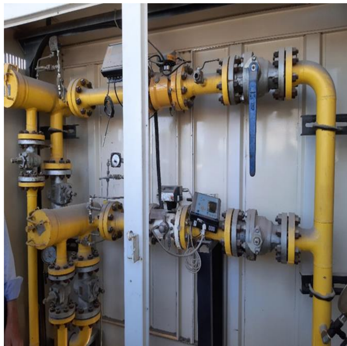
شکل 1 ایستگاه گاز CNG
